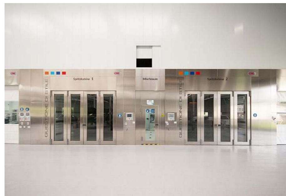
Die beiden Spritzkabinen von CMC. In der Mitte der Mischraum.
